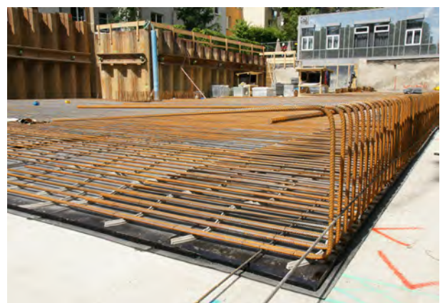
Die Bewehrung ist auf der Dichtungsbahn ausgelegt und die Bodenplatte zum Betonieren vorbereitet.
